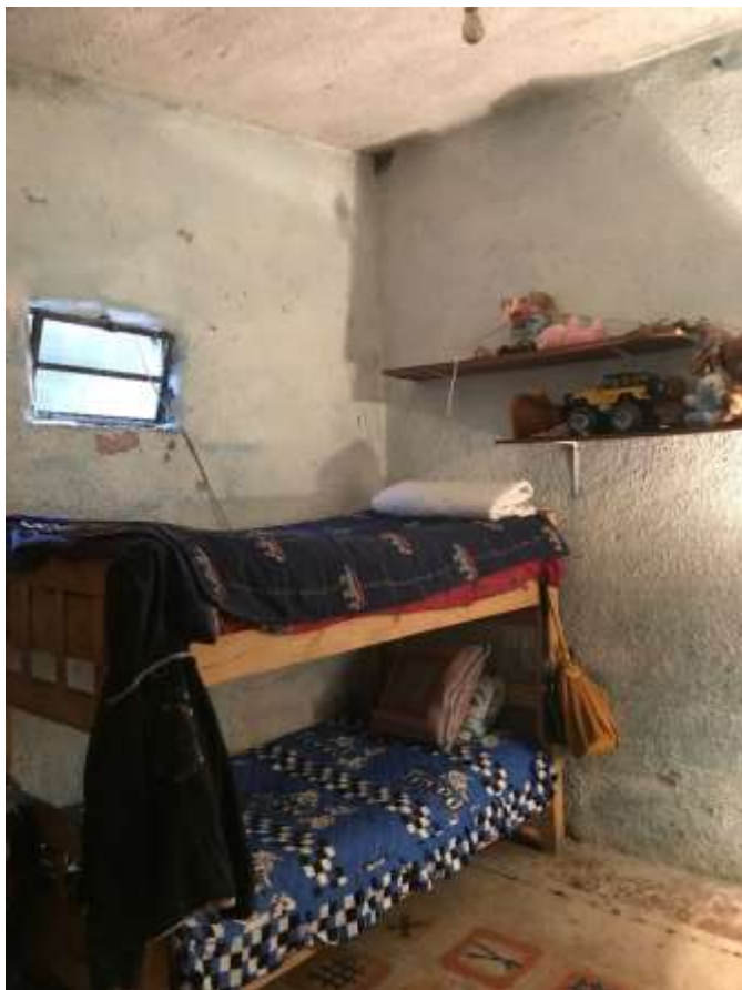
Escasa ventilación e iluminación
