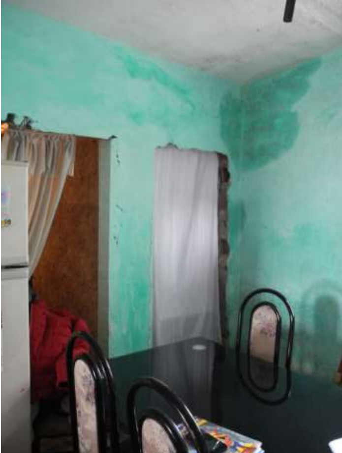
Filtraciones y humedades; falta de puertas interiores
