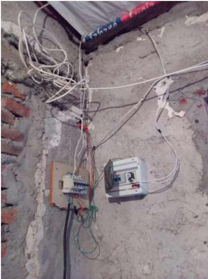
Cables eléctricos expuestos Paredes sin revoques
