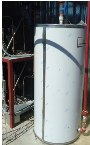
Tanque Recuperador de Calor
