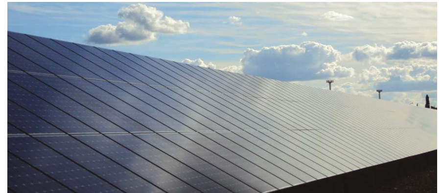
Planta de energía solar fotovoltaica de ASAHI, Salto
