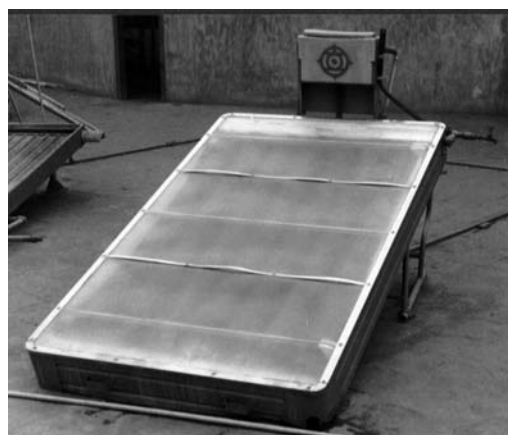
Figura 6.1 – SCAES del tipo integrado, el pequeño tanque en su cabecera mantiene el nivel y lo conecta con el suministro de la red.
