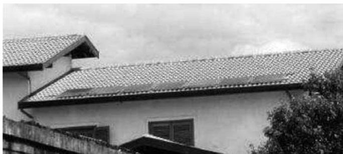
Figura 6.16 – Instalación de mini colectores en larga batería (Fuentes: acervo Soletrol)
